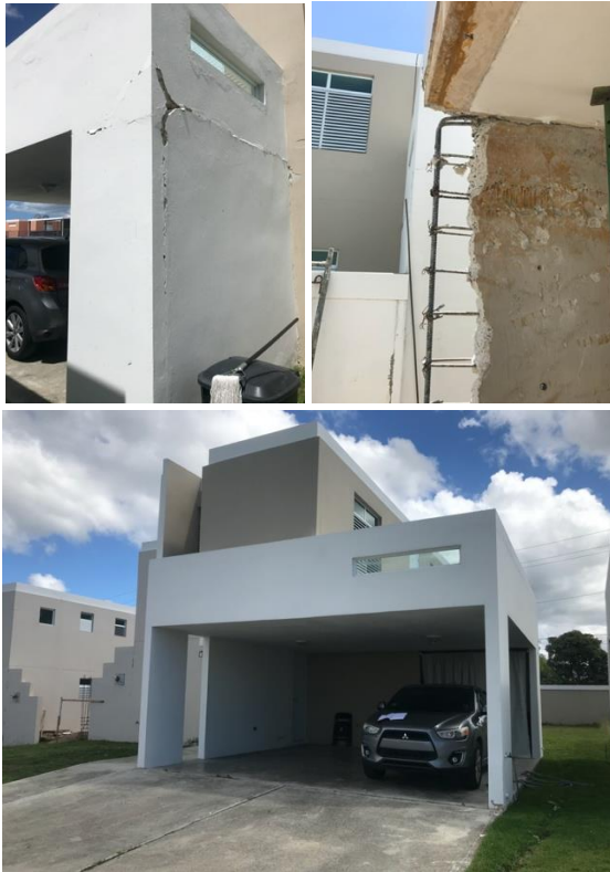
Figura 2 Efectos del sismo en la estructura bajo estudio
