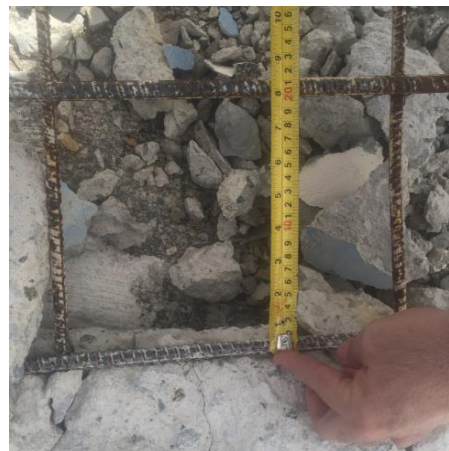
Figura 6 Varilla No. 4 a 8 Pulgadas
