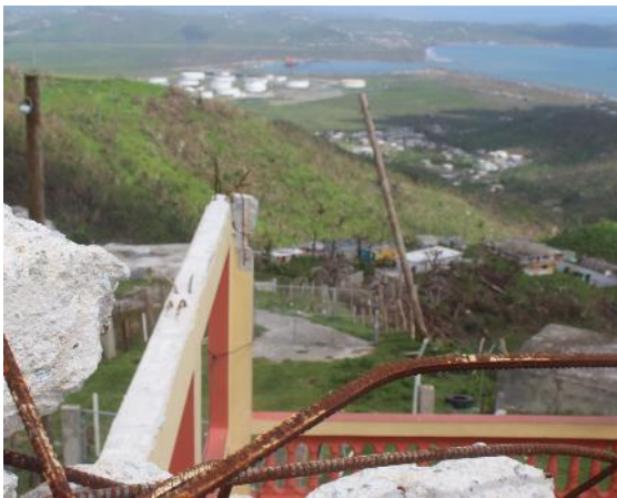
Figura 8 Falta de Conexión Entre Losa y Pórtico
