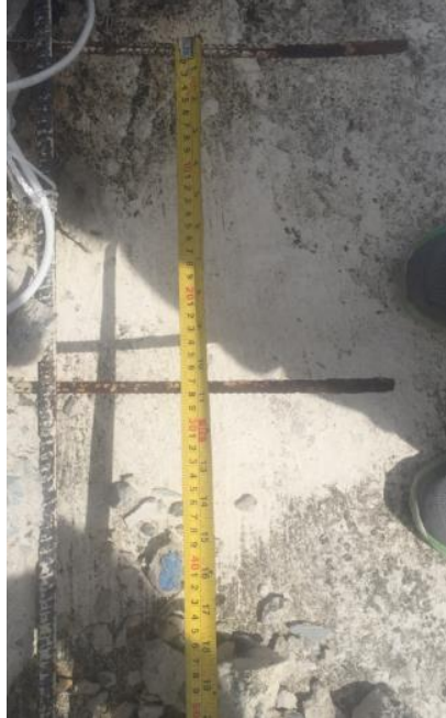
Figura 7 Varilla No. 3 a 11 Pulgadas
