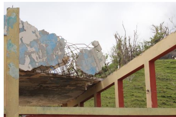
Figura 2 Falla en Losa de Techo
