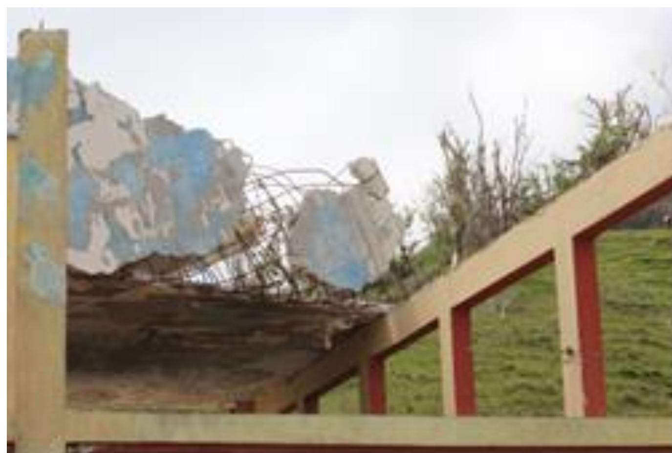
Figura 1: Falla de losa
