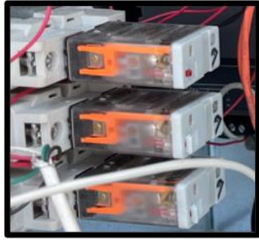
Figura 6 “Relays” instalados para el Sistema de Control
