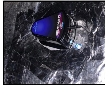
Figura 8 Purificador de Aire Instalado
