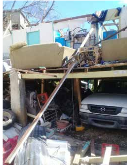
Imagen 3. Pérdida total de la residencia de Carmen Paula y su compañero Santiago en Villa Hugo II, San Isidro, Canóvanas, Puerto Rico luego del huracán María. (Fotografía: PNO-ASA)
