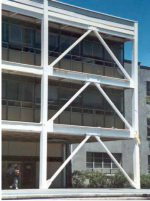
Figura 13 Arriostramiento externo de acero
