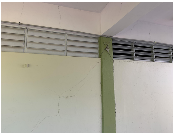
Figura 5 Grieta por esfuerzos cortantes en columna y pared
