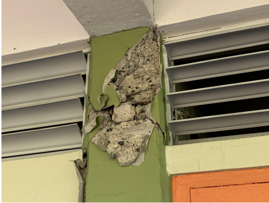
Figura 4 Daño por efecto de columna corta
