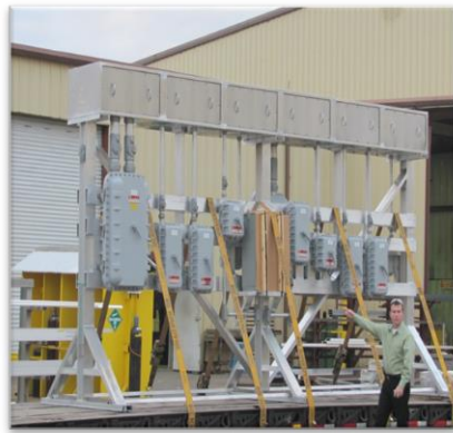
Figura 1 Foto de un “switchcrack”
