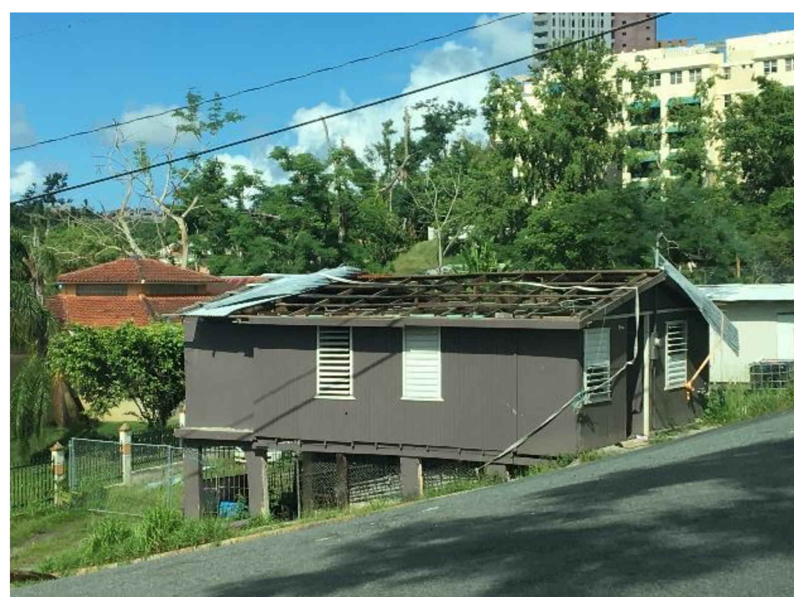
Vista de Varias Residencias que Perdieron Revestimiento del Techo Luego del Huracán María
