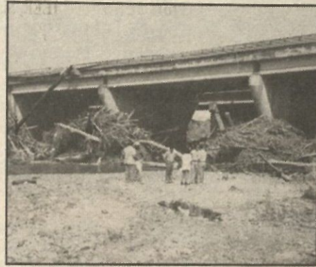
Daños bajo puente de carretera estatal.
