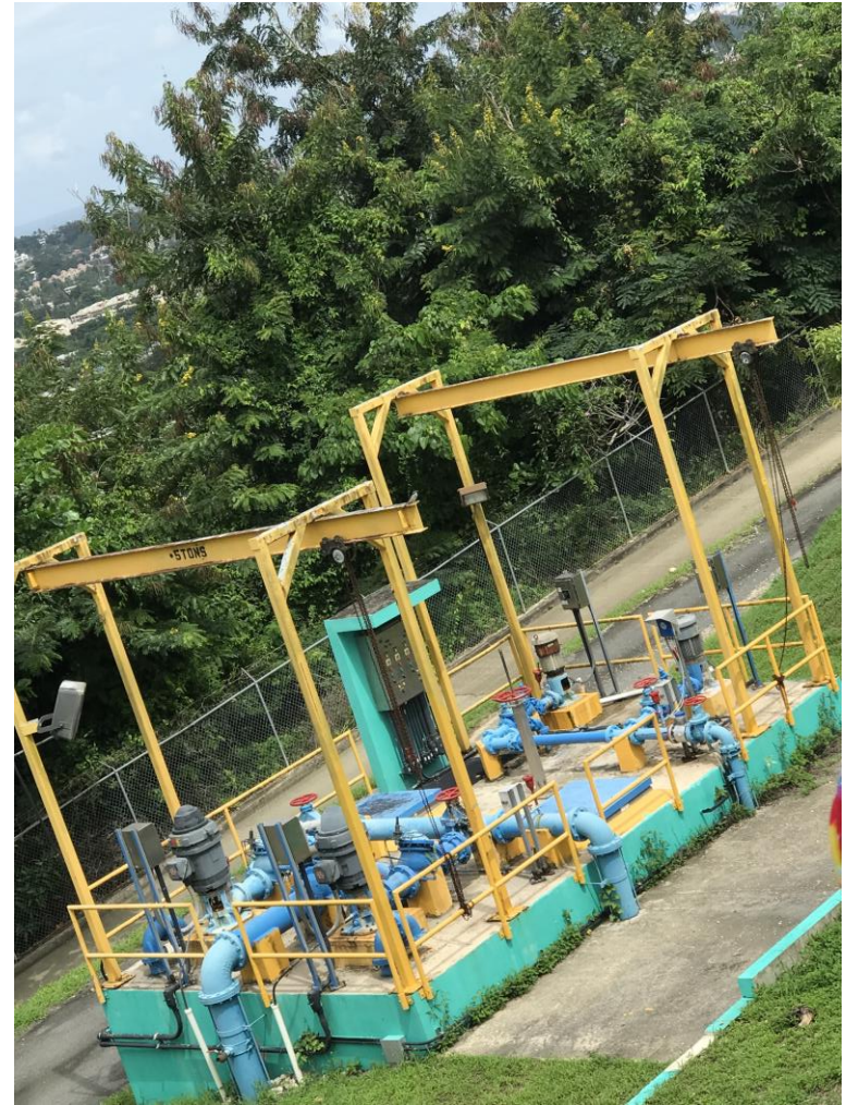
Sistema de Bombeo para Distribucion de Agua Potable
