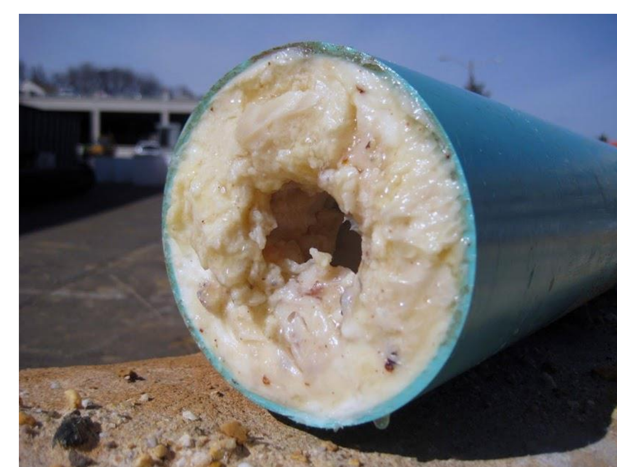
Tubería obstruida por aceites y grasas.
