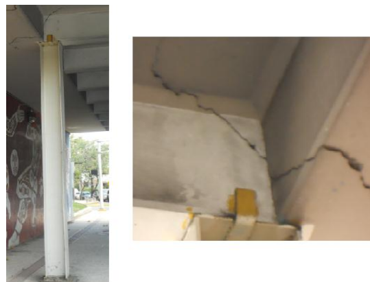
Figura 2 Columna Temporera y Viga Afectada.
