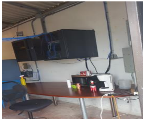
Figura 3 Servidores sin Ventilación Mecánica
