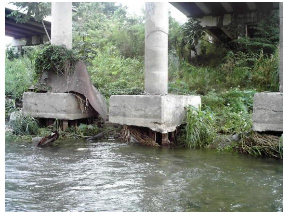
Figura 1 Degradación del Lecho Río Inabón – Puente PR-52
