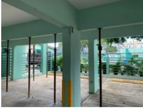
Figura 4 Falla en Columna del Primer Nivel del Edificio
