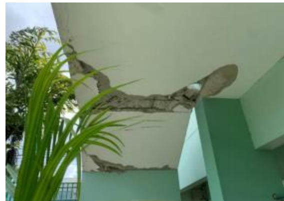
Figura 8 Falla en Escalera Vista Inferior
