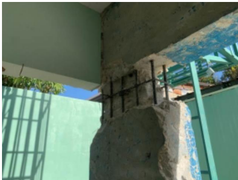
Figura 5 Falla en Columna
