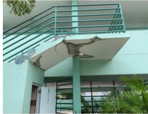
Figura 7 Falla en Escalera Vista Lateral
