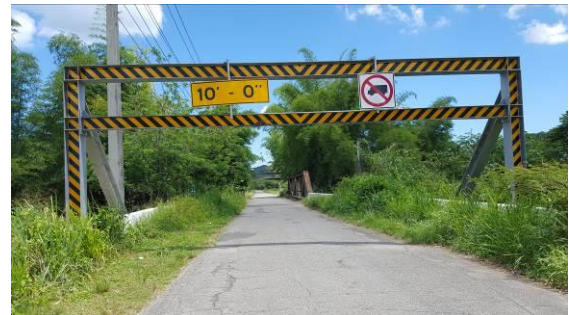
Figura 6 Pórtico Instalado para Limitar la Altura de los Vehículos
