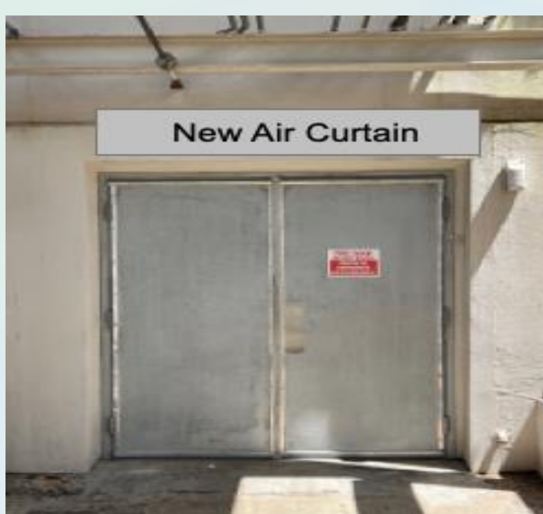
Figura 4: Puerta Exterior Sin Cortina de Aire
