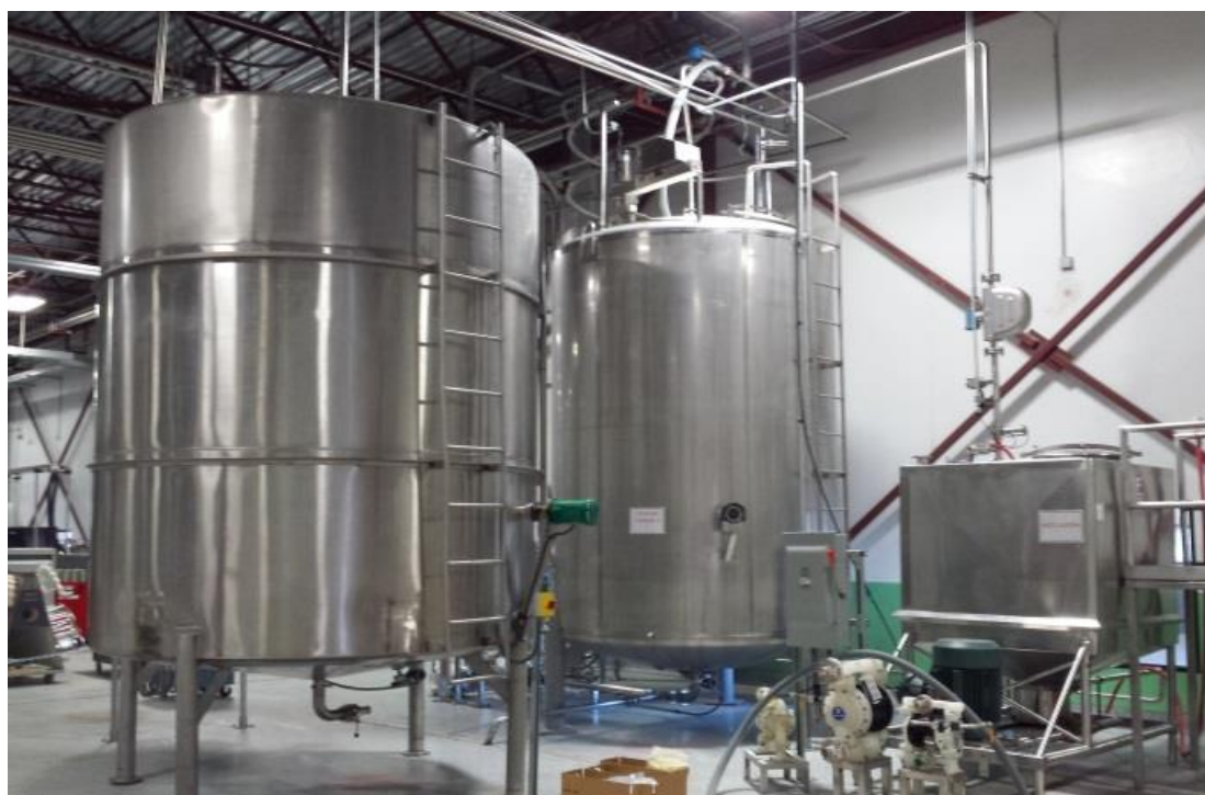
Figura 5 Tanque HFCS, Tanque 1 y Mezclador
