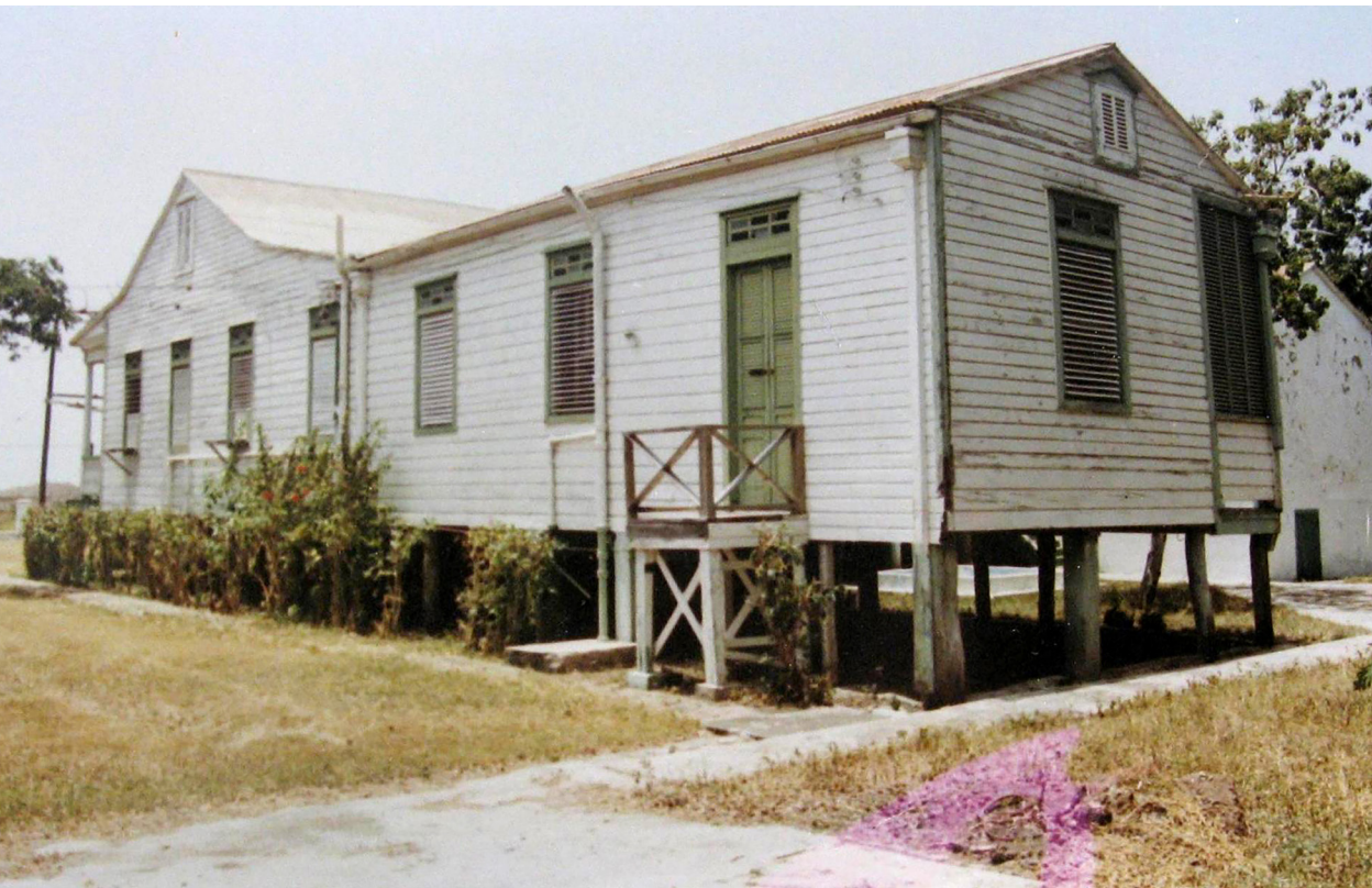
Imagen 7.2. Hacienda La Esmeralda, casona de la familia Usera, barrio Jauca II, Santa Isabel, 2007. Vista posterior mostrando galería y parte del volumen principal, ambos deteriorados. (Foto: JOC).
