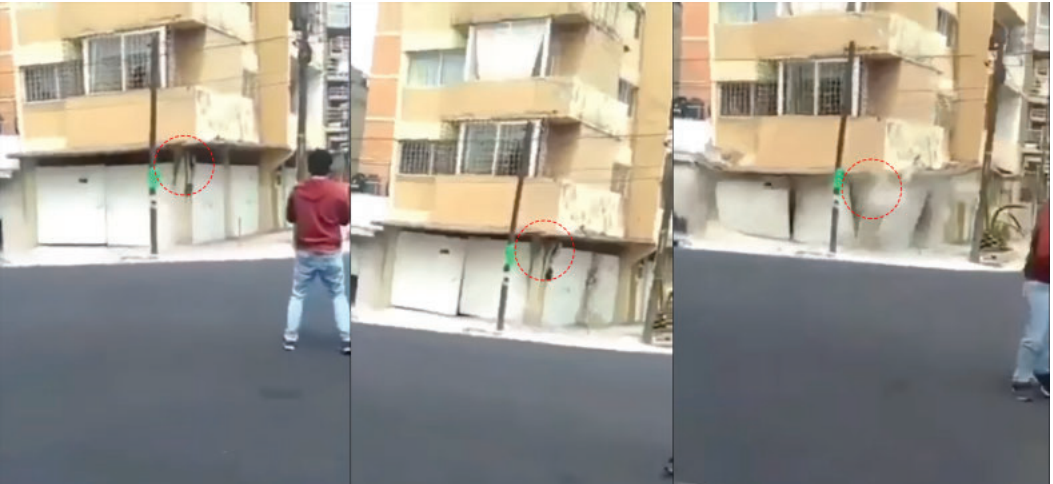
Imagen 5. Fragmentos de video, mostrando la falla estructural de una columna de un edificio habitacional. (Fuente: @OBLIX/YouTube)
