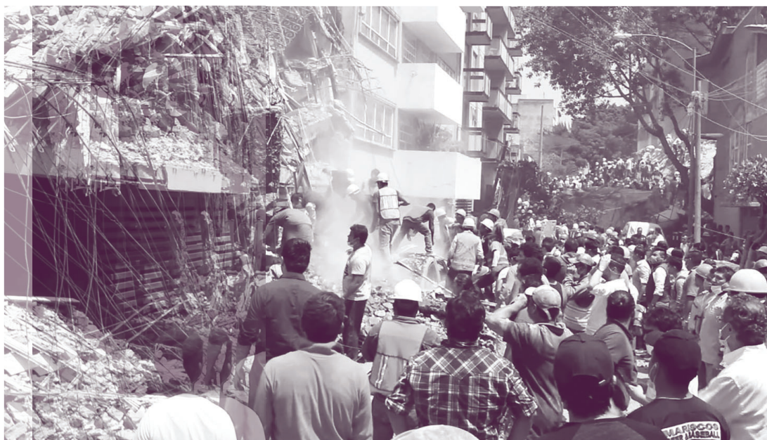
Imagen 3. Derrumbe en calle Escocia y Gabriel Mancera. (Fuente: Archivo Proceso)
