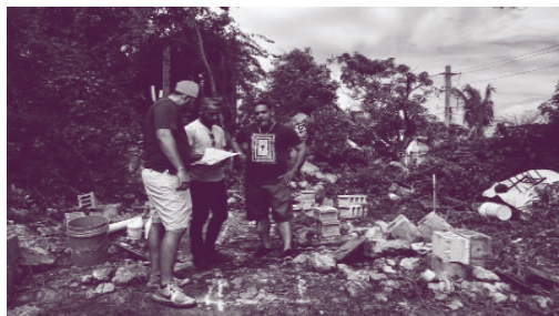
Imagen 5. Participantes del proceso constructivo definen la colocación de los cimientos. (Fuente: TECHO/Francisco Susmel)
