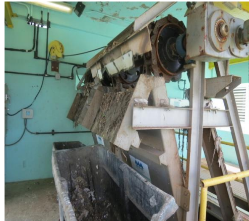
Figura 4 Sistema de Screening, Planta Los Naranjos, Vega Baja
