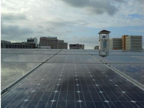
Figura 2 Sistema Fotovoltaico en Edificio L
